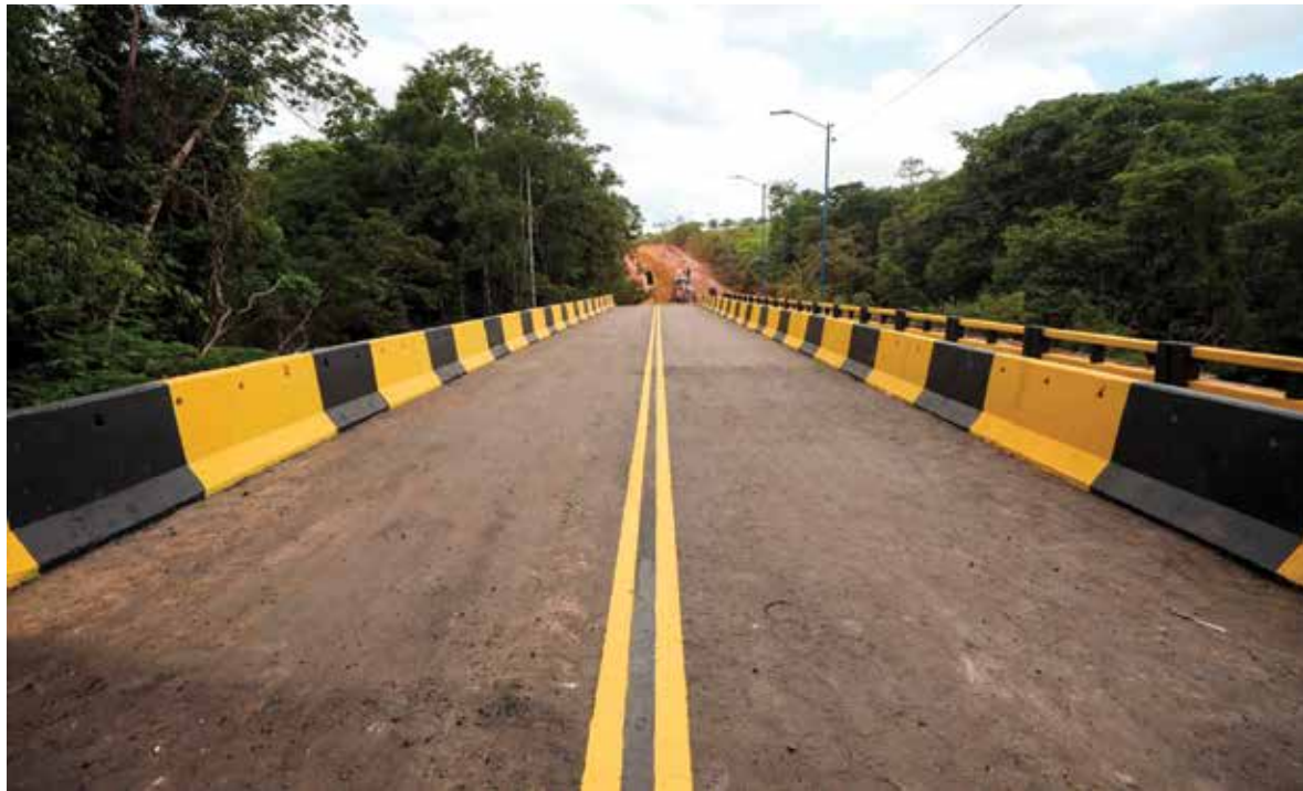
Construção de ponte de concreto armado com 40 metros de comprimento em vicinal de acesso a Vila dos Remédios, comunidades de Santa Rosa, Fé em Deus e Pau Amarelo no município de Aurora do Pará.
