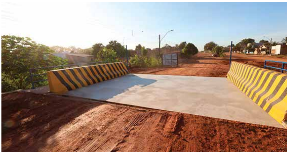
Governo promove entrega de sete pontes de concreto armado em estradas de Redenção.
